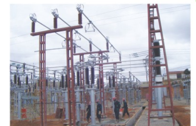
Interruptor LW36-72,5 de gas SF6 Funcionando en Madagascar LW36-72.5 SF6 Circuit Breaker in Madagascar
