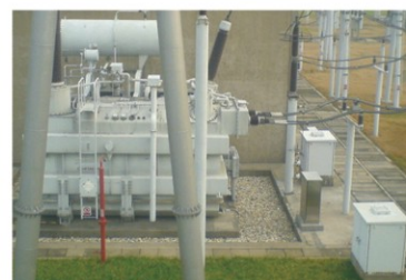
DGA TROM-600 funcionando en la provincia de Jiangsu TROM-600 DGA in 500kV Substation Jiangsu Province
