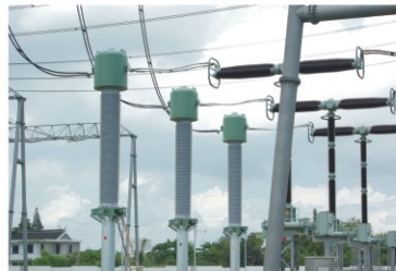
Transformadores de corriente LVQB-550 funcionando en la provincia de Jiangsu LVQB-550 SF6 Insulated CT in Jiangsu Province
