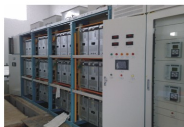
SVG QNSVG-50000/10 funcionando en la red eléctrica de Shanghai QNSVG-50000/10 SVG in Shanghai Power Company
