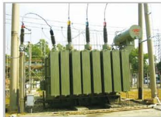
福建省南安市电力总公司 Operating in Fujian power corporation
